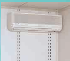
エアコン取付支柱
